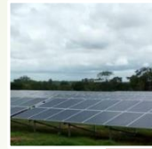
la base solaire
